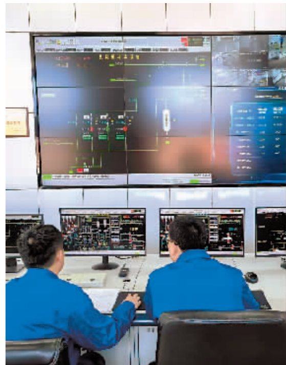
热企智慧平台实时监控居民室温及供热系统运行情况。
