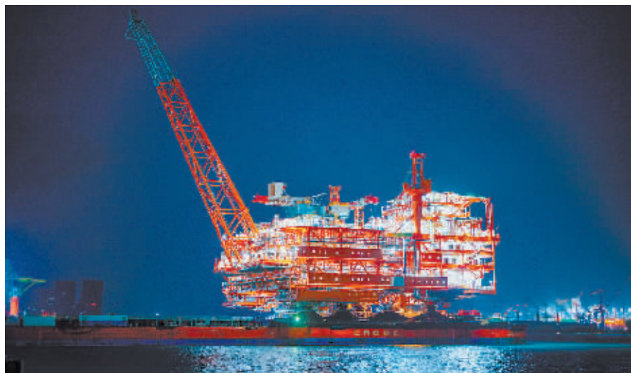
渤中26-6油田一期开发项目中心平台装船作业现场。新华社发
