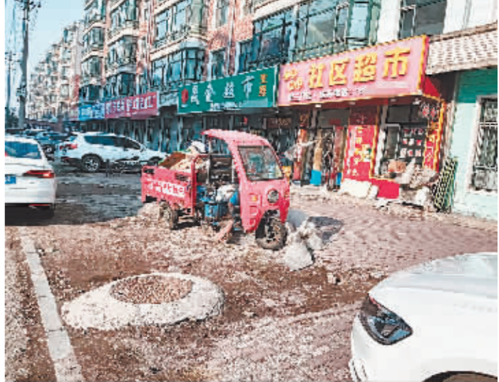
巴彦县石桥路人行道破损。
