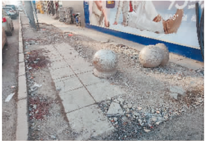
尚志市合作路人行道板破损。
