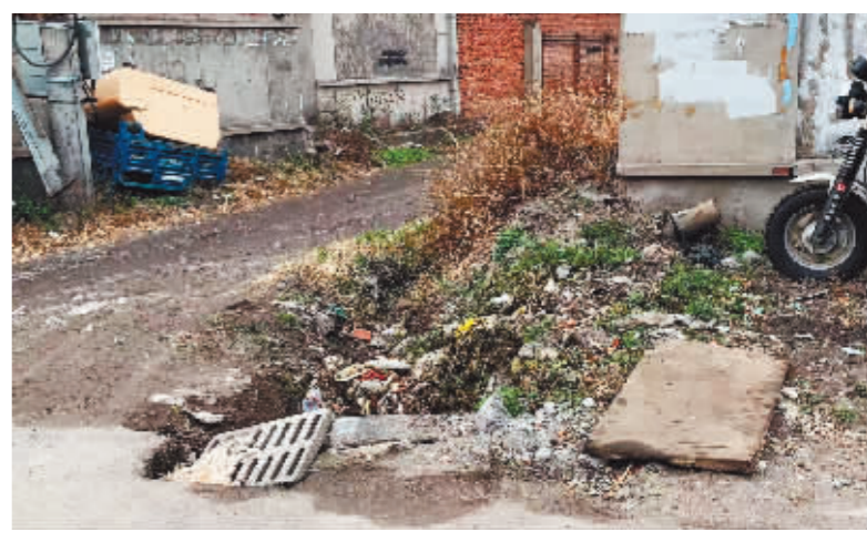
双城区升平胡同排水沟垃圾废弃物。
