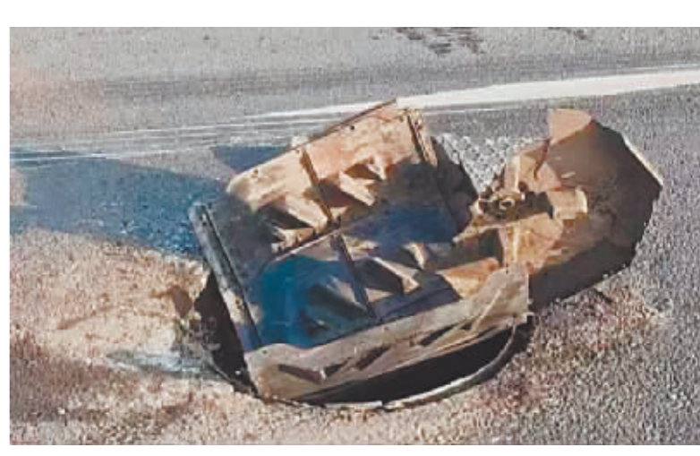
木兰县振兴大街423号井盖缺失。
