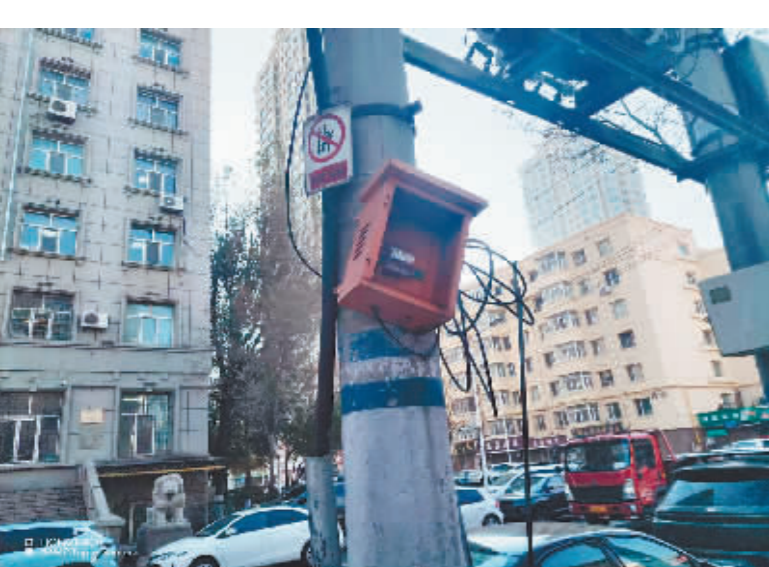
道外区长春街与北十四道街交口电力控制箱盖缺失。
