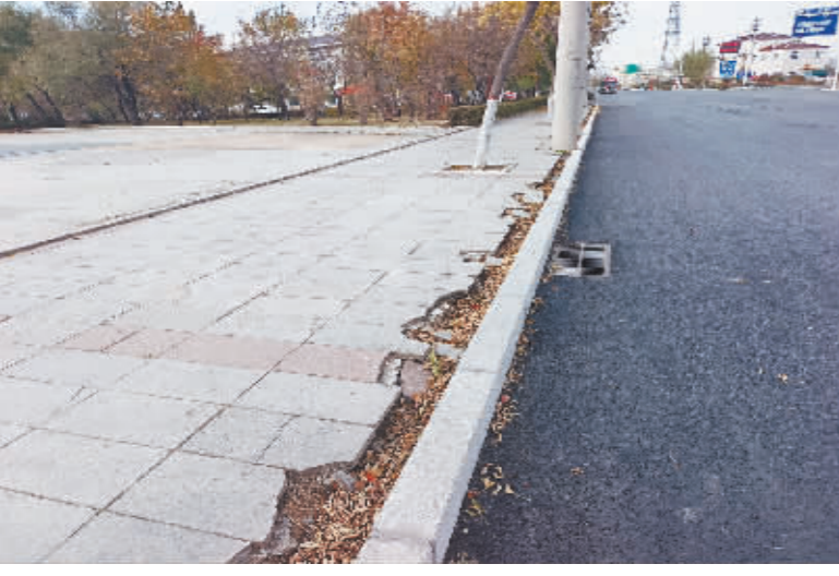
依兰县五国城路盛世名城小区广场步道板破损。
