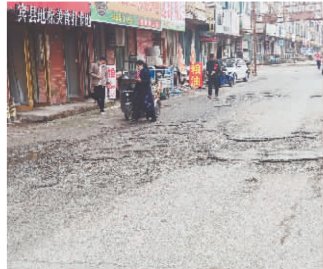
宾县城隍西路109号道路破损。
