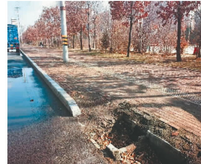
巴彦县文化公园北道路破损。
