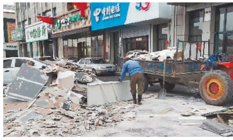
尚志市铁通公路华农贸市场建筑垃圾。
