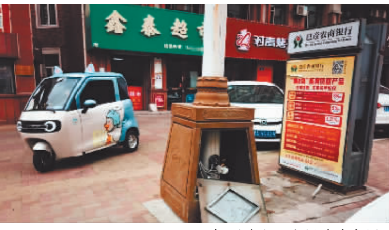
巴彦县北直路31号路灯杆底座破损。
