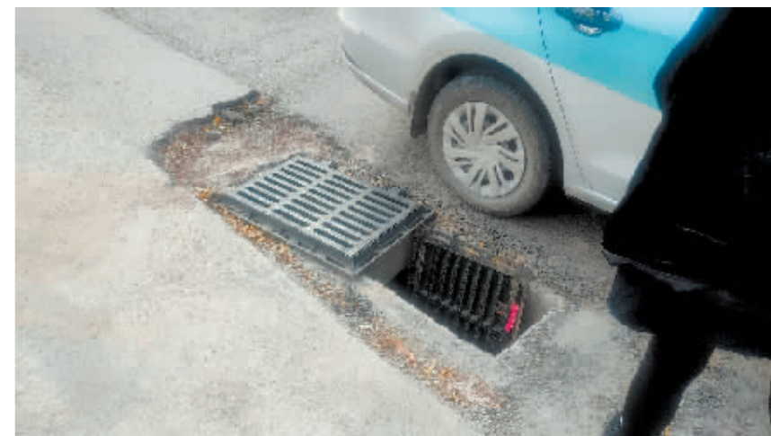
尚志市铁通路天添旺粥铺门前排水井盖破损。
