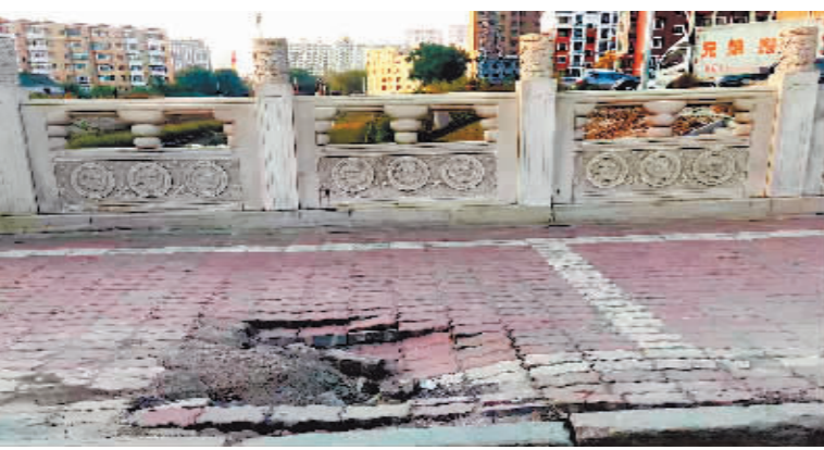
阿城区上京大道397号人行道塌陷。
