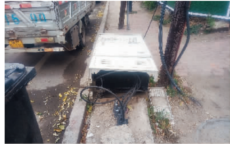
双城区西门和兴家园门东侧移动通信交接箱体倒伏。
