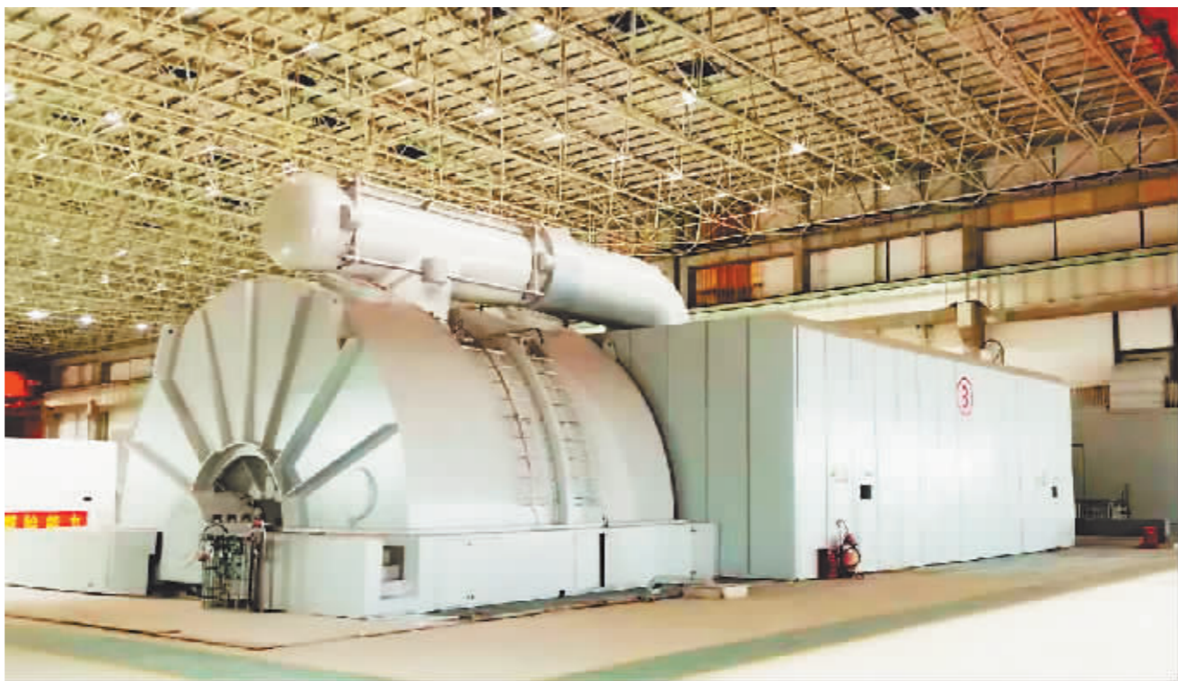
3号燃气—蒸汽联合循环热电冷联产机组顺利通过168小时试运行。
