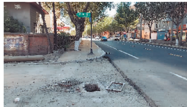
尚志市尚志大街朝阳路并巷子未覆盖。
