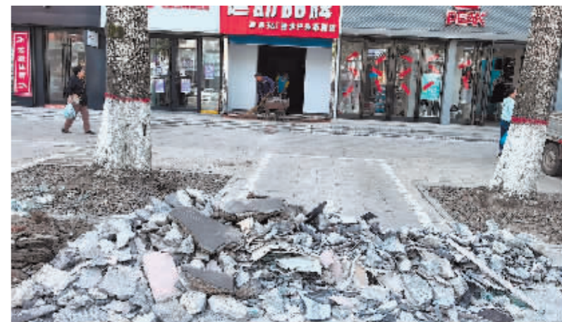
木兰县木兰大街298号有建筑垃圾。
