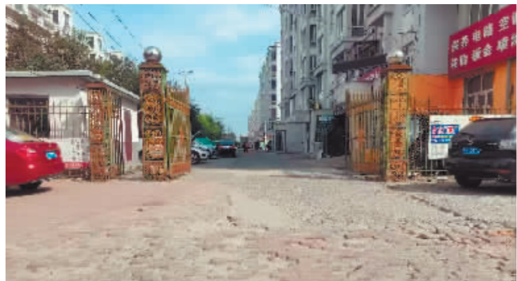
阿城区四中东路沿江小区门前人行道板破损。
