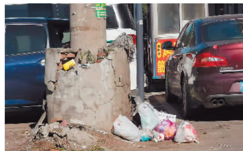
松北大道135号附近垃圾乱堆、电线杆底座破损。
