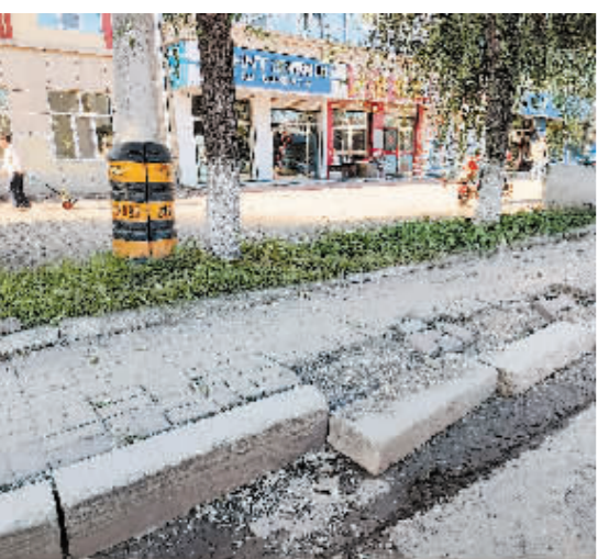
方正县蚂蚁河街与农林路交口路边石倒塌。
