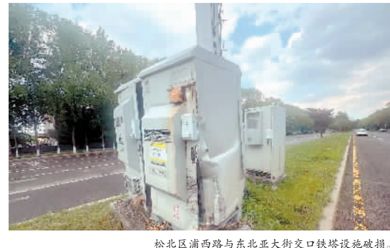
松北区浦西路与东北亚大街交口铁塔设施破损。
