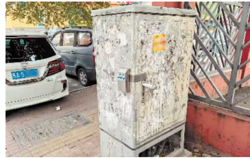
南岗区中兴街区域移动箱体脏污破损。
