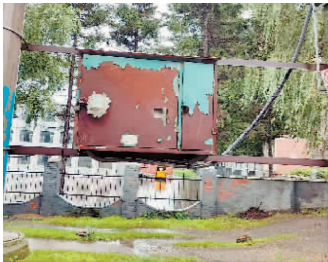
阿城区中都大街660号门前电力箱体锈蚀。
