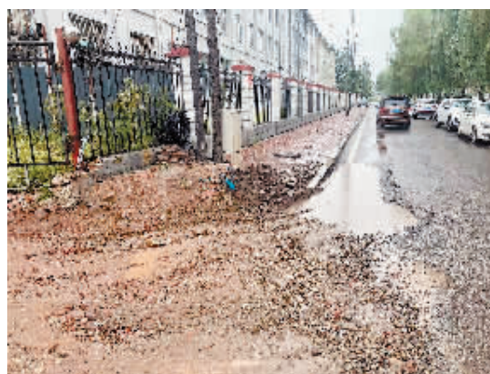
木兰县木兰镇高级中学路面破损、边石缺失。
