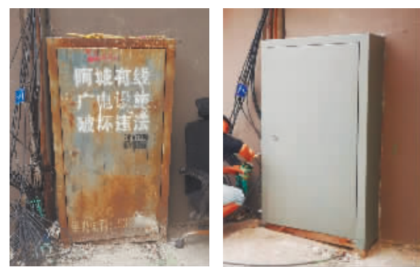
阿城区永泰乡企楼东山墙箱体锈蚀整改前后。
