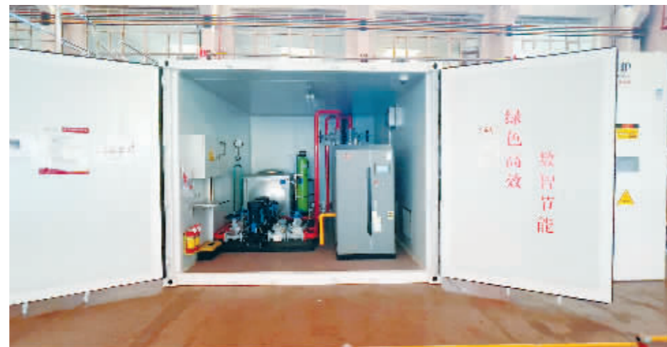
新研发的应急锅炉房功能齐全。
