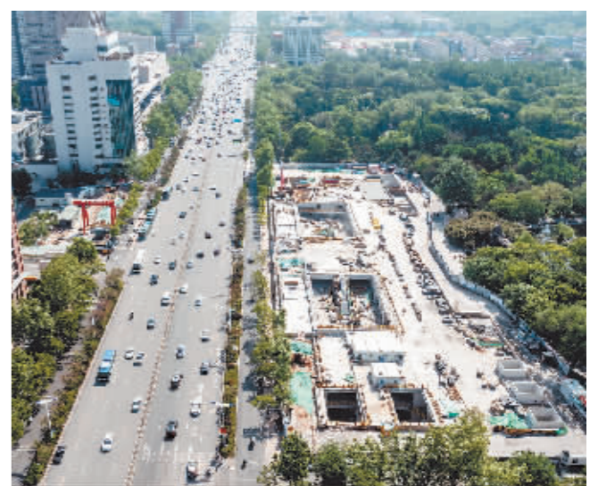
济南地铁4号线泉城公园站至千佛山站区间隧道贯通施工现场。新华社发
