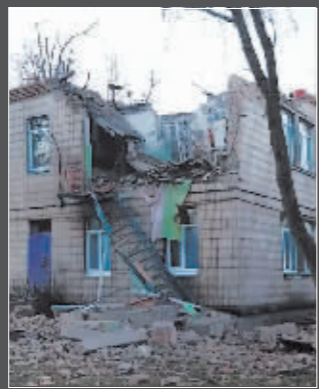
2023 年 11 月 25 日,在乌克兰基辅市,一栋建筑屋顶被无人机碎片击中。
