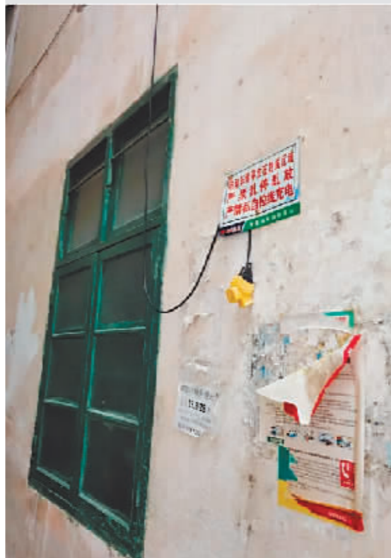
一小区住宅楼单元入口处的“飞线”。
