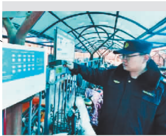
安全生产检查人员在检查居民区内的电动自行车充电设施。
