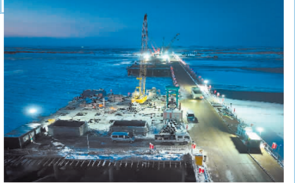
铁科高速建设现场,施工人员在加紧作业。省交通运输厅供图
