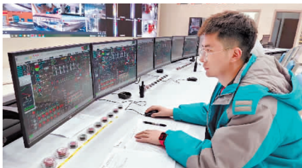
工作人员在中央控制室监控各个环节。
