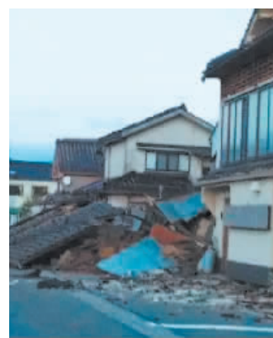
地震中受损的房屋。
