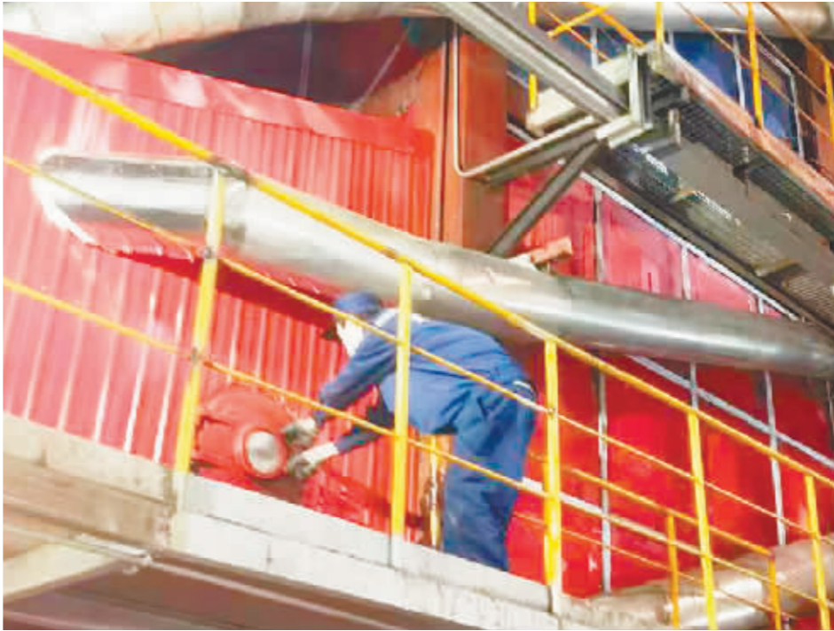
工作人员检查供暖设备。
