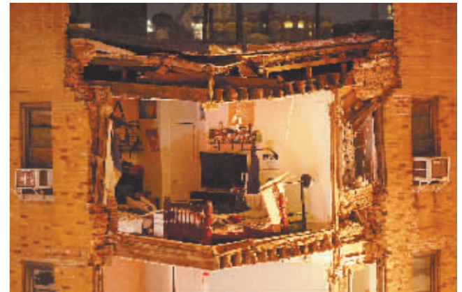
这是12月11日在美国纽约市布朗克斯区拍摄的发生坍塌的公寓楼。 新华社发
