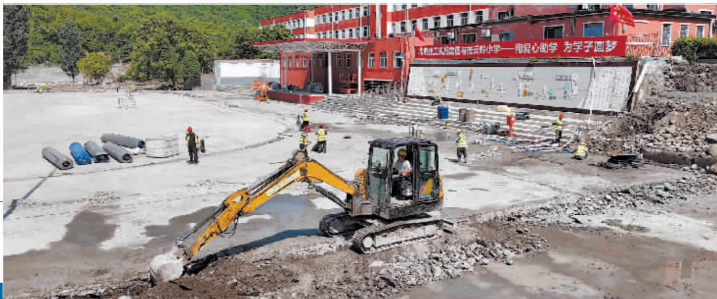
8月23日,施工人员在北京市房山区一所小学内,对被洪水冲垮的操场进行修复。新华社发
