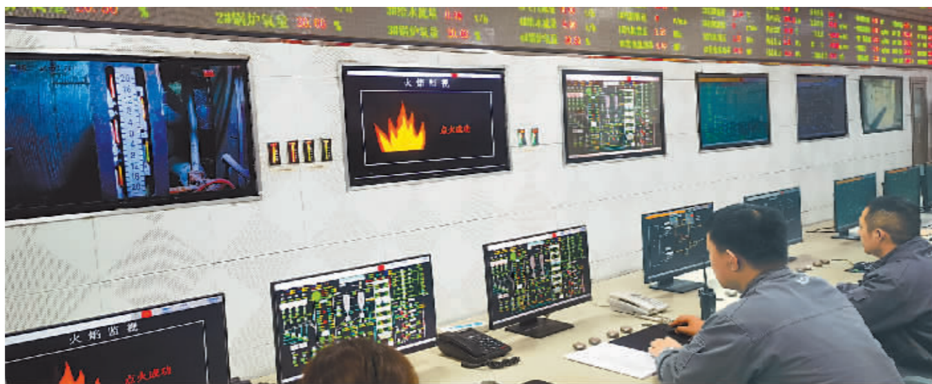
威立雅启动供热系统热态运行。
