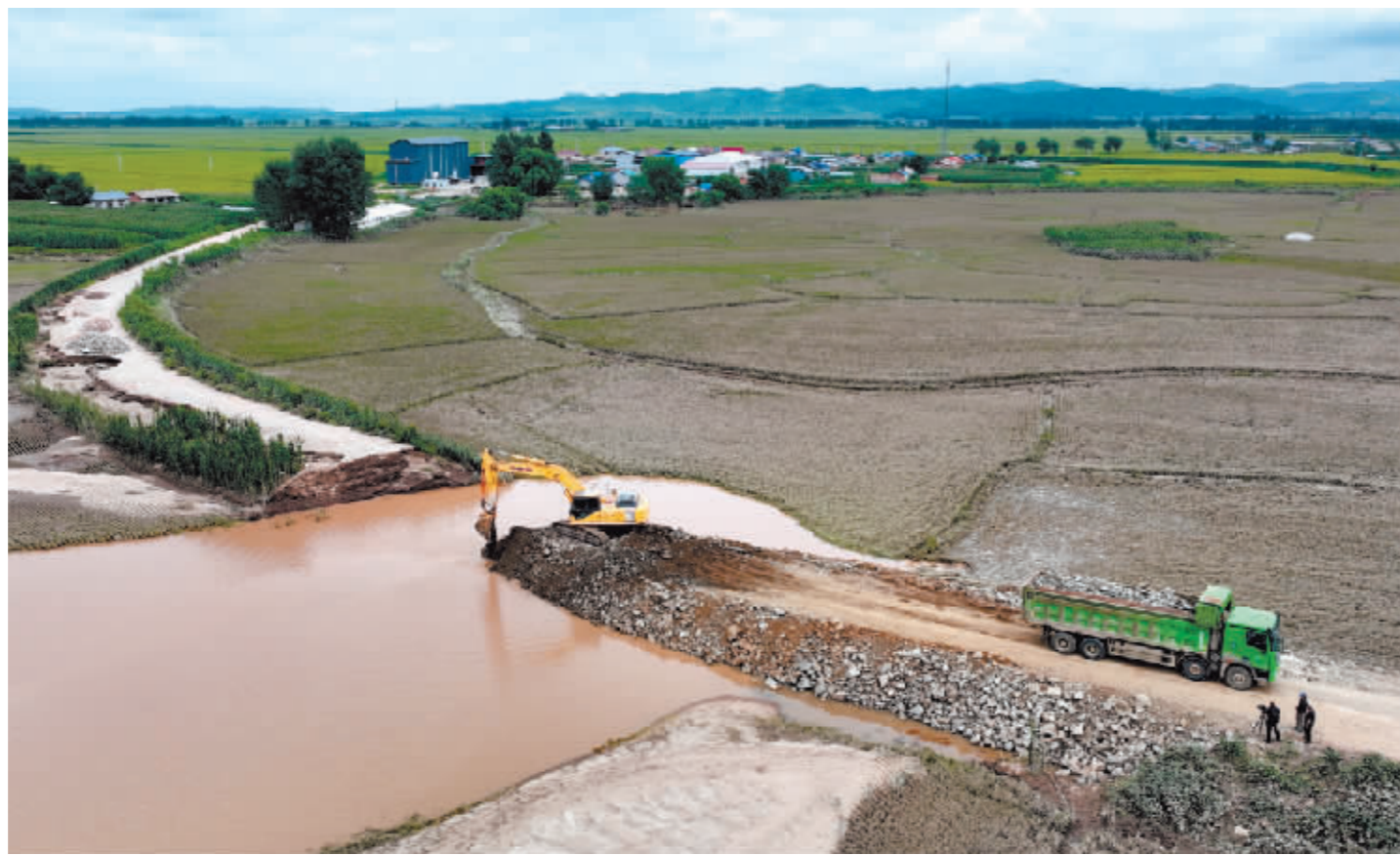
水利部门正在封堵五常市杜家镇吕家屯水毁大坝缺口。 本组照片由本报记者韩伟摄
