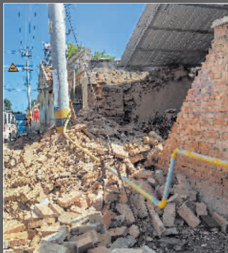
一处房屋和燃气管道因地震受损。
