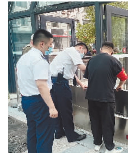
地铁车站设置挡水板。
