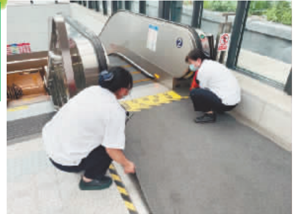
哈尔滨地铁3号线劳动公园站的工作人员在电动扶梯口等易打滑区域摆放防滑垫。
