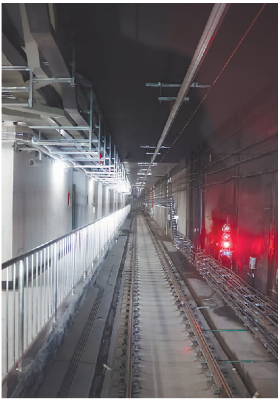
地铁3号线西北环右线北马路站轨道铺设完毕。本报记者 韩伟摄
