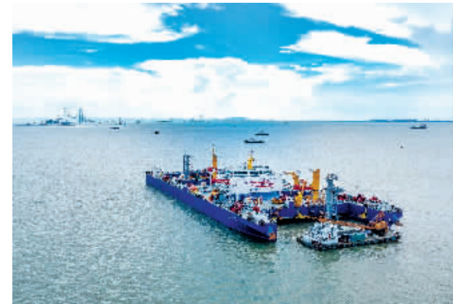
“一航津安1”号沉管运输安装一体船在沉放安装E23管节和最终接头,背后是建设中的深中通道伶仃洋大桥。
