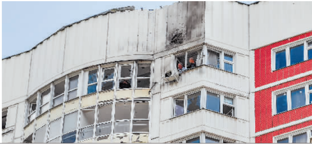
这是5月30日在俄罗斯首都莫斯科拍摄的受损建筑。 新华社发
