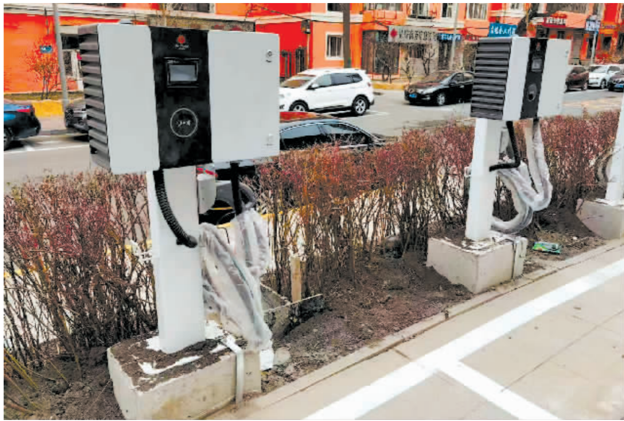
市民大厦附近停车场建好的充电桩。
