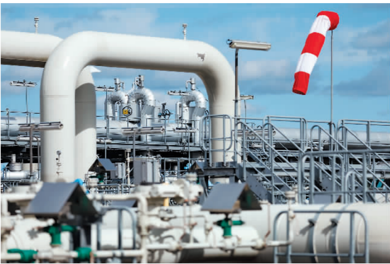
这是2022年8月30日在德国卢布明拍摄的“北溪-1”天然气管道。
