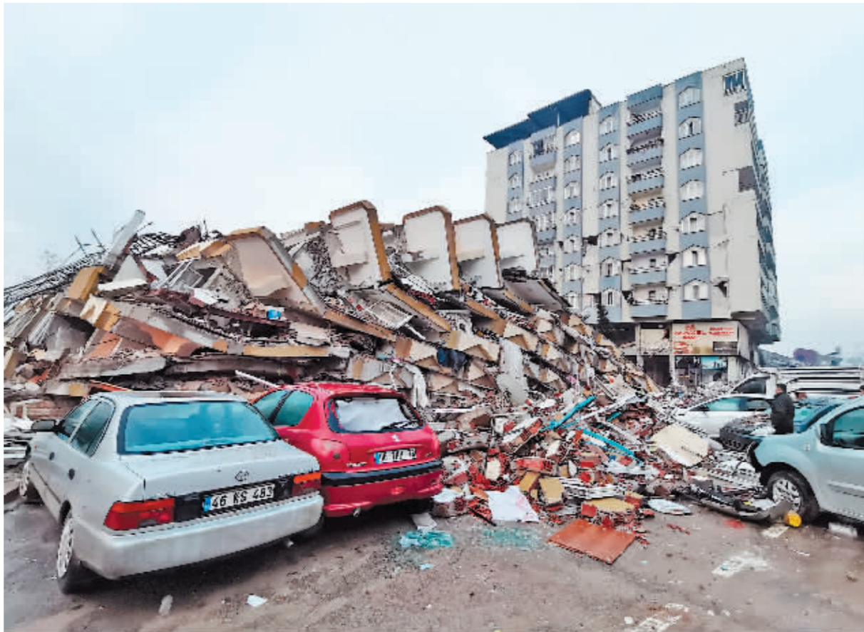
这是2月7日在土耳其卡赫拉曼马拉什拍摄的一处倒塌的建筑(手机照片)。
