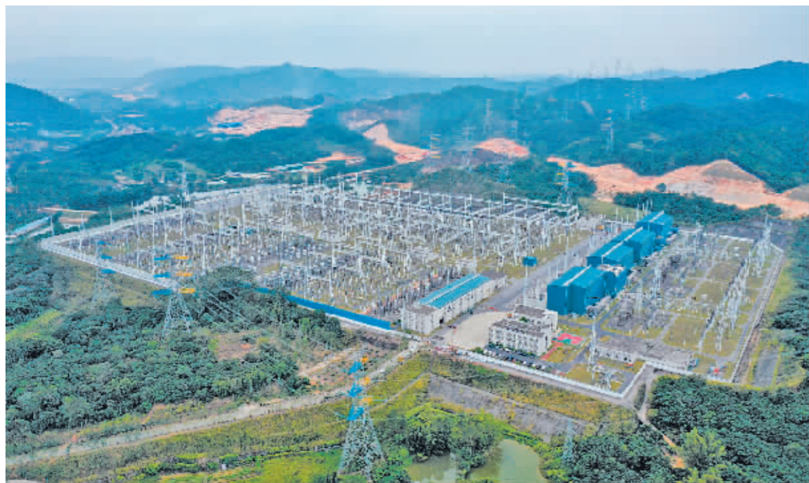
图为溪洛渡直流工程从西换流站。
