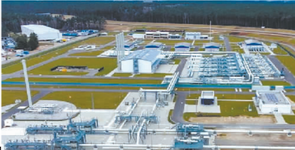
“北溪-2”天然气管道项目登陆设施的管道。
