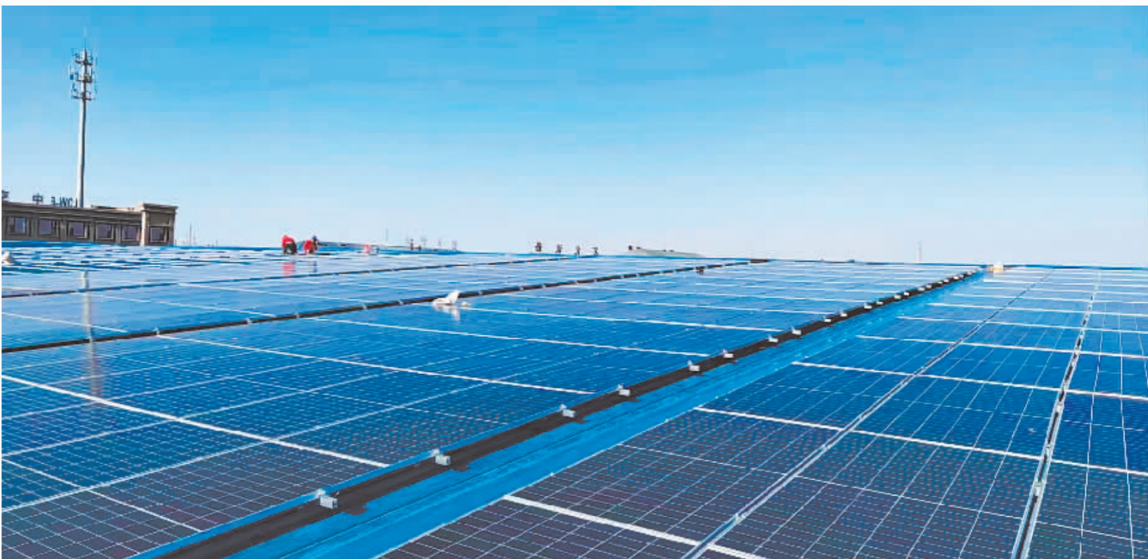
新奥能源控股有限公司黑龙江分公司铺设的地面光伏项目。
