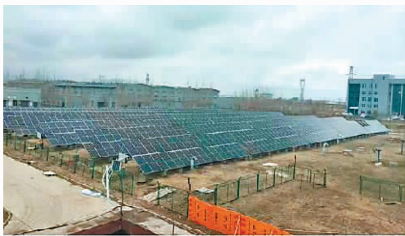
地面光伏项目现场。
