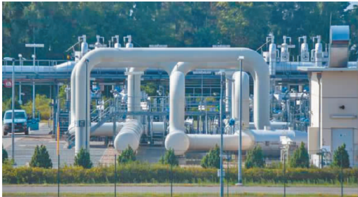
“北溪-1”供气管道。
