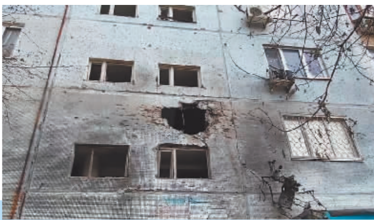
战火中破损的建筑。
