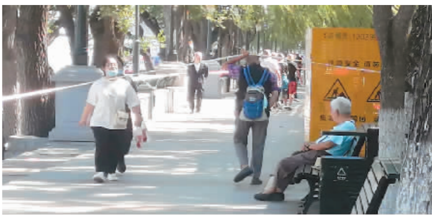
游人随意穿越施工安全线。
