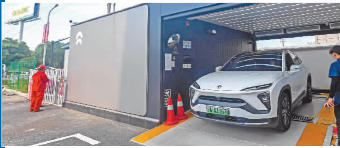
6月7日一台电动车来到浙江长兴一处刚投运的电动汽车充换电站,进行快速换电。
