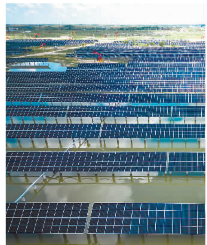
7月21日拍摄的大庆油田星火水面光伏项目(无人机航拍) 新华社发
