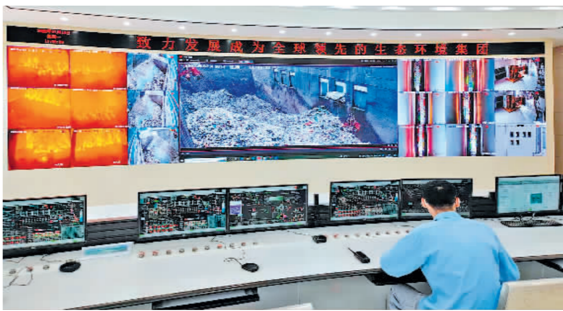
中心控制室内,值班人员时刻监测电脑显示的各项数据。
