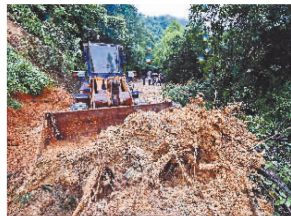
6月14日,受强降雨影响,福建省建瓯市迪口镇龙北溪村附近道路被山体塌方阻断,救援人员在清理土石。新华社发
