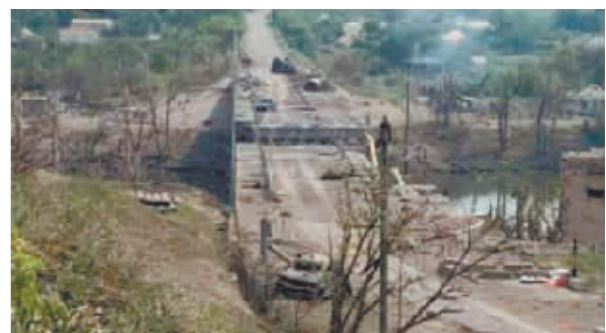
北顿涅茨克市被炸毁的桥梁。
