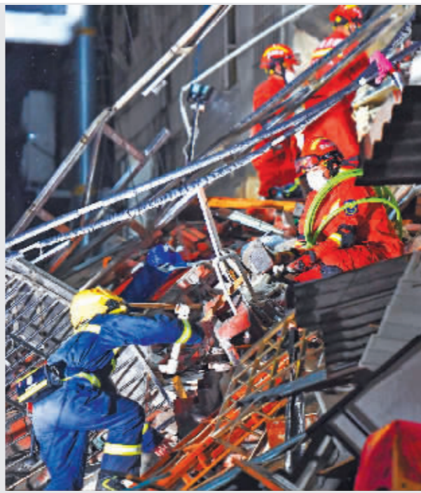
救援人员在事故现场通宵搜救。
