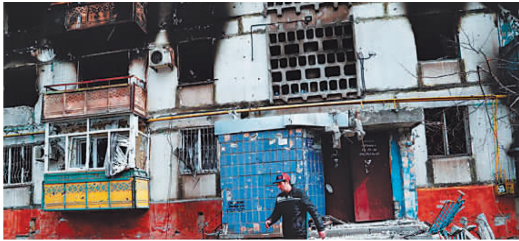
乌克兰马里乌波尔,居民经过被损坏的建筑。
