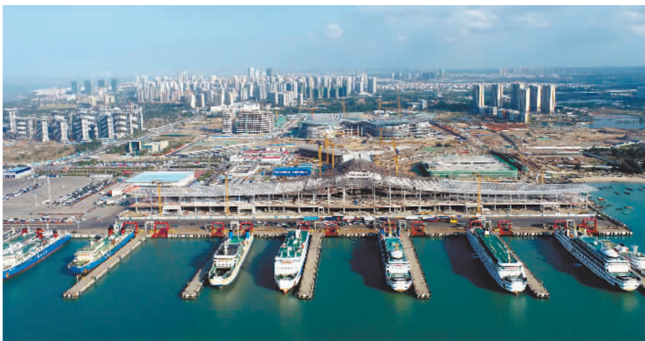
这是2022年2月11日拍摄的海口新海港客运综合枢纽项目施工现场。
