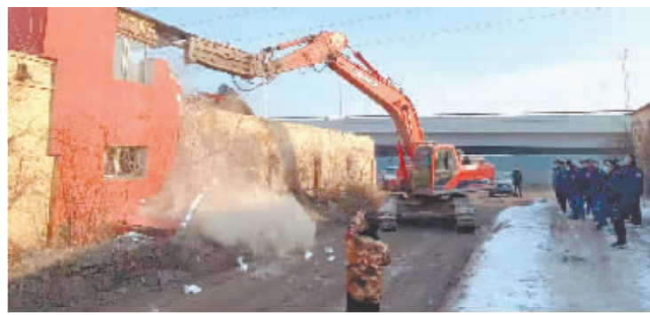
对违法建筑零容忍，一律予以拆除。
