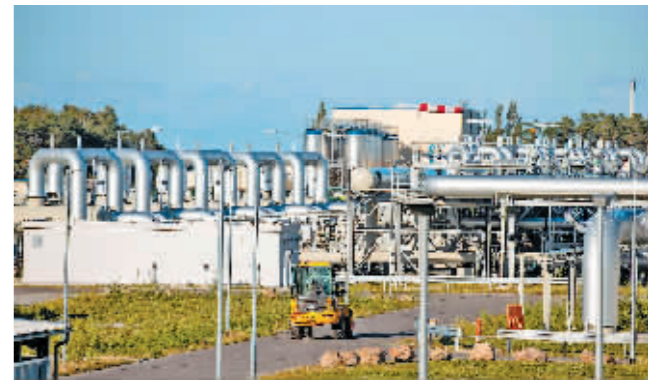
图为德国的“北溪-2”天然气管道项目设施。
