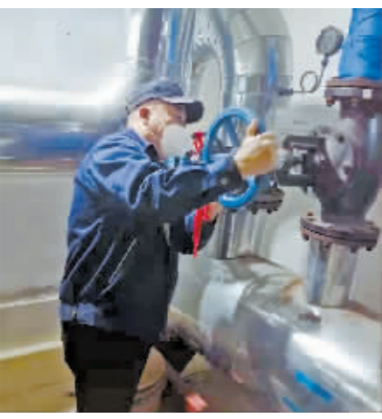
工作人员正在查看供热设备运行情况。
