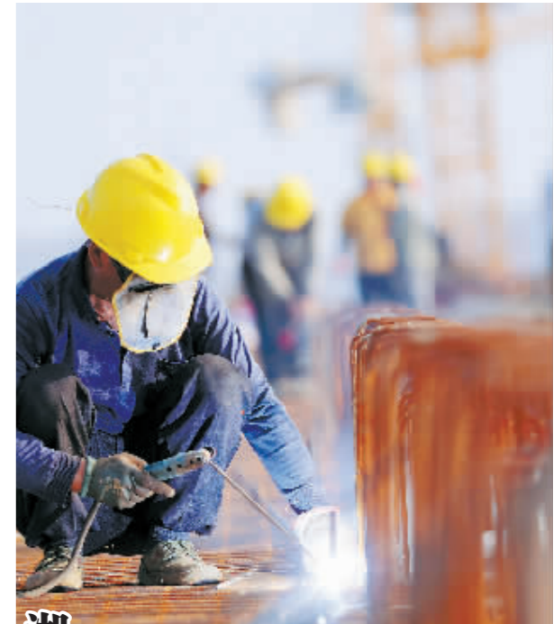
10月3日,建设者在湖南省永州市道县207国道绕城公路拓改工程潇水二桥拓宽大桥项目工地施工。 新华社发
